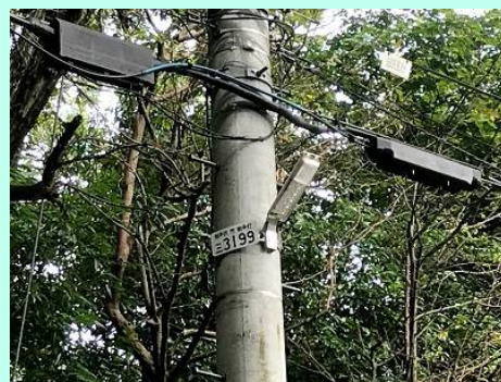
道路照明灯のLED化（東狭山ヶ丘）
